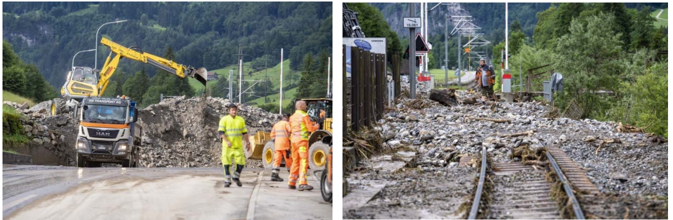
Der Eltschenbach bei Wolfenschiessen verschüttete die Hauptstrasse.
